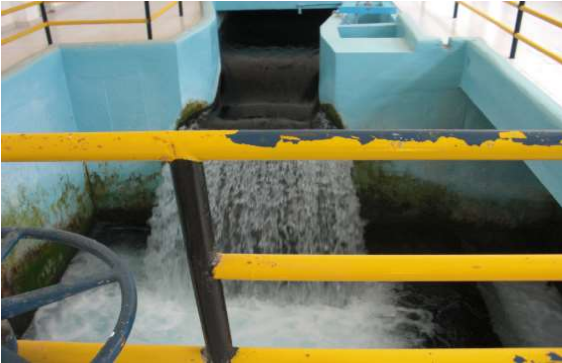
AGUA DEL SOCAVÓN
