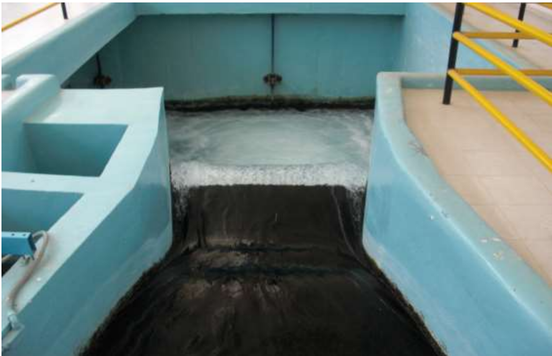
OTRA TOMA DEL SOCAVÓN
